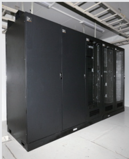
深圳松岗基站
